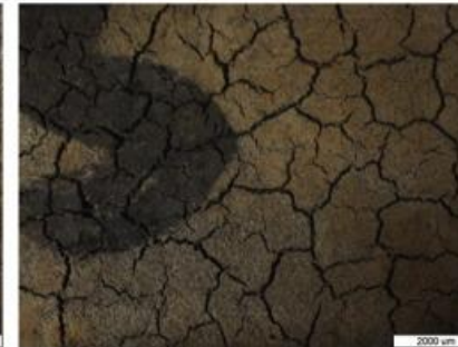
(d) Drying after 28 days corrosion
