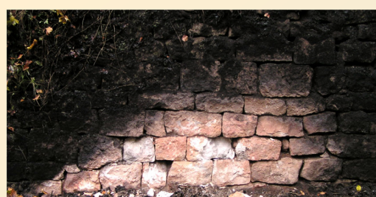
Kamenná zeď poškozená požárem
