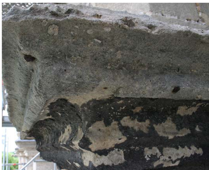
Obr. 5.8 Detail poškození travertinu se silně zanesenou povrchovou zónou na římse Petschkova paláce Praze.
