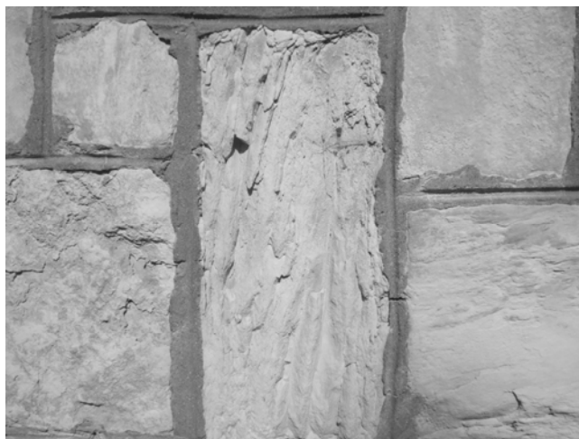
Obr. 5.7 Porušení opukového kamene nesprávně uloženého ve směru působení zatížení na sedimentární vrstvy.
