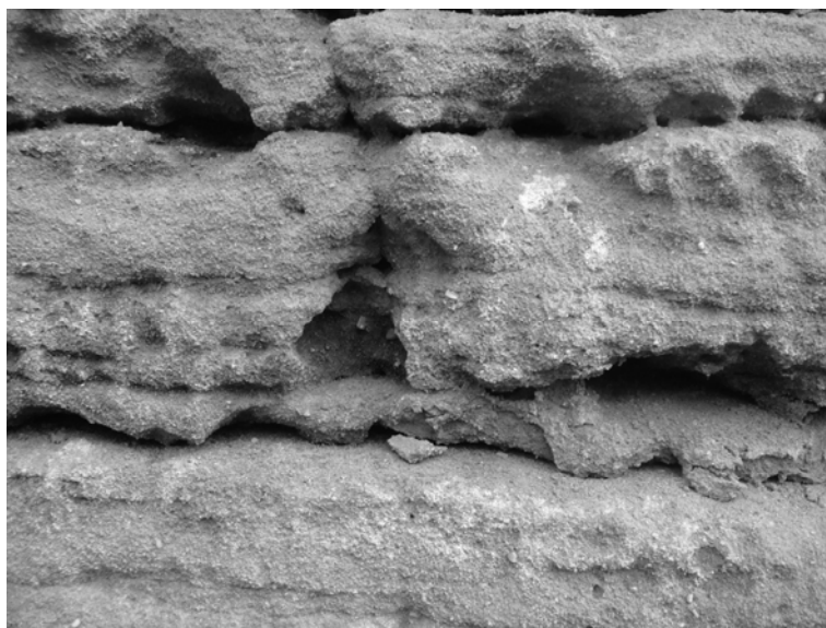
Obr. 5.11 Postup rozpadu pískovcového zdiva.
