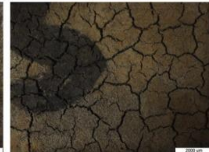
(d) Drying after 28 days corrosion
